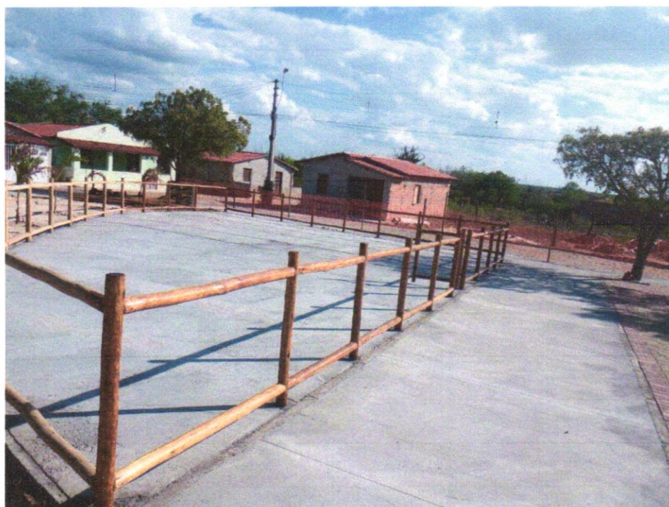
Foto 08 - FORNECIMENTO E MONTAGEM DE CERCA DE PROTEÇÃO EM EUCALIPTO CLOEZIANA TRATADO A BASE DE CCA EM AUTOCLAVE, COM APLICAÇÃO DE STAIN NA COR NATURAL COM DUPLO FILTRO SOLAR, DIAMETRO DO EUCALIPTO DE 6 A 8 CM, COM ANTI-RACHA NA EXTREMIDADE, FECHAMENTO COM TELA DE ALAMBRADO FIO Nº 12 REVESTIDO DE PVC, MALHA 2.1/2 X 2.1/2", FIXADO COM FIO Nº 14 REVESTIDO EM PVC, MÓDULO MEDINDO 1,50 X 1,00M, PARAFUSOS GALVANIZADOS COM TRAVAMENTO CLICKFIX, CONFORME PROJETO
